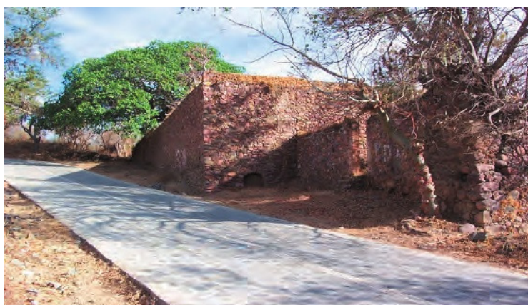
Figura 16 y Figura 17. Barda perimetral colindando con la calle principal de acceso al poblado de Taxco el viejo. Se observan los muros de piedra rodada y los vegetales parásitos que ya han afectado la estructura.
