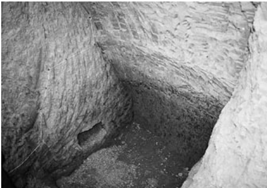
FIG. 12. Detalle del talud de arcilla notablemente erosionado por la fuerza del agua a embalse lleno (Foto: J. Andreu).
