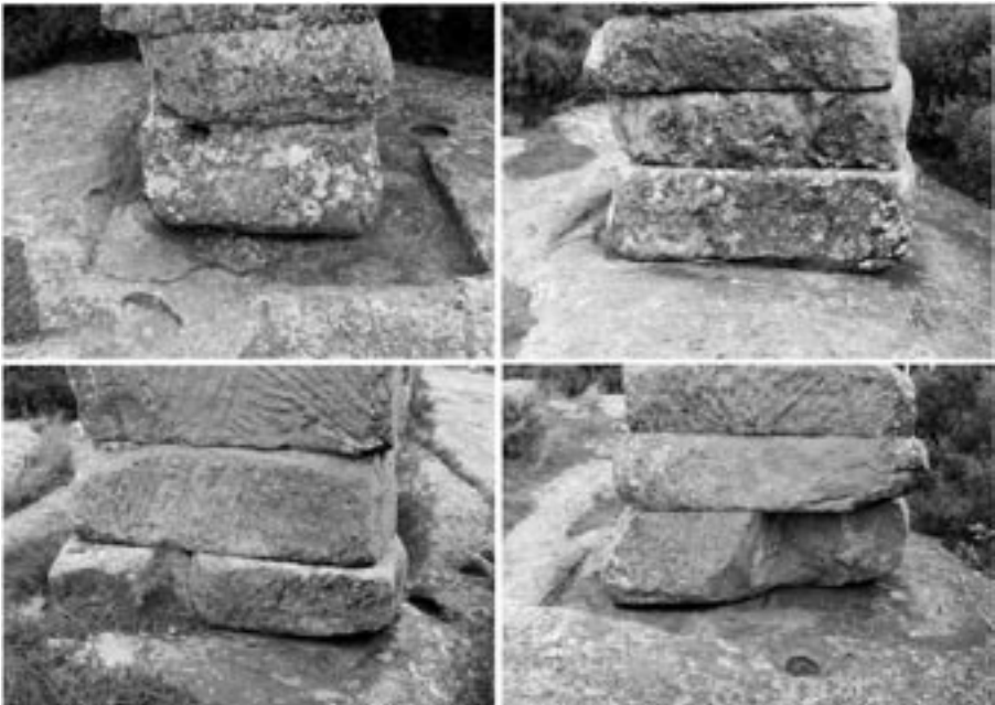
FIG. 20. Descalce de pilares.
