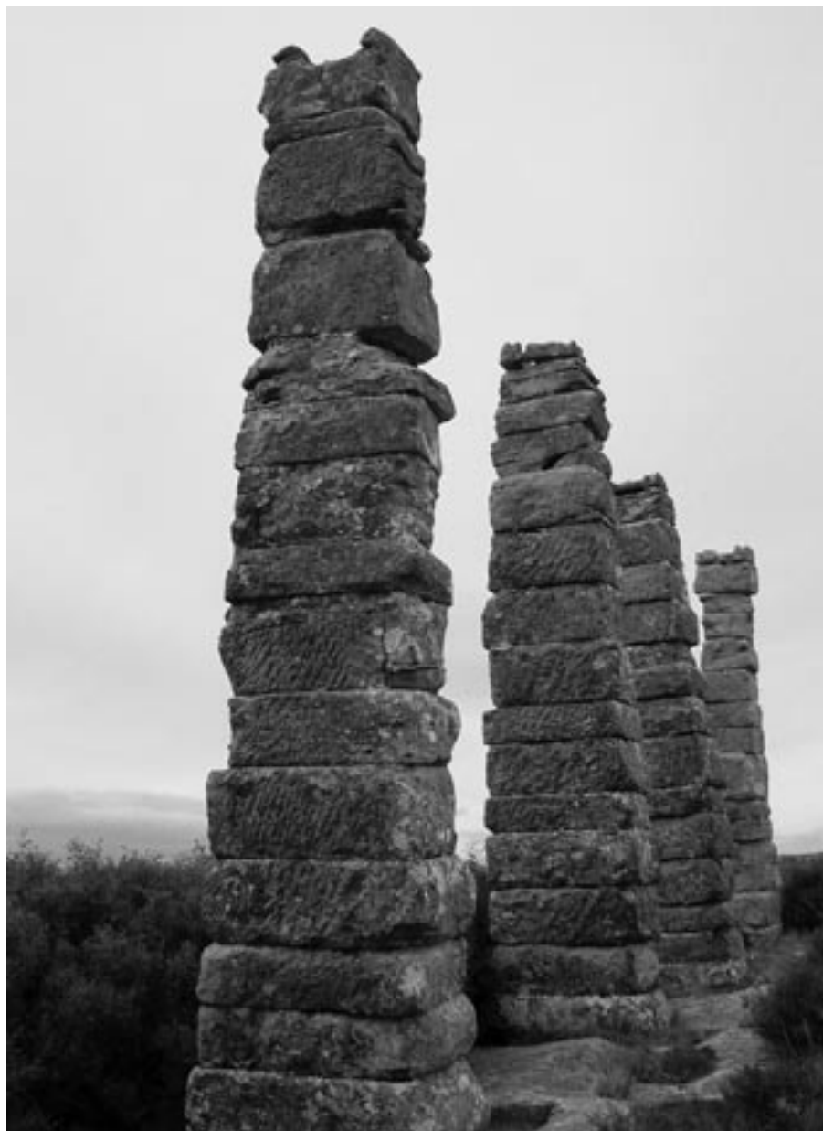
FIG. 17. Detalles de pilares P19 a P22, se observan diversas patologías en sillares intermedios y de coronación.
