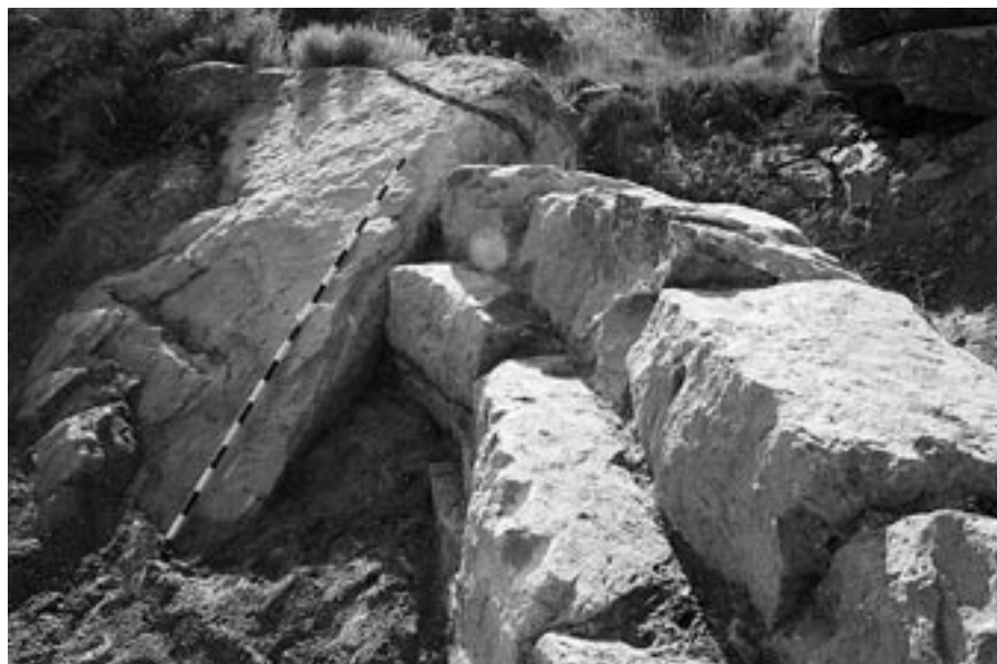
FIG. 6. Detalle del estribo Oeste de la presa de Cubalmena, apoyado sobre el afloramiento rocoso del terreno (Foto: J. J. Bienes).
