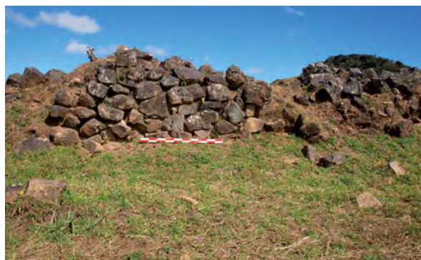
Figura 14. Estructuras murarias afectadas por el proceso de desbroce y tala.
