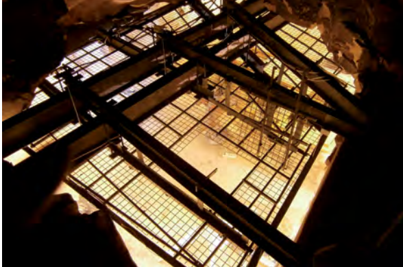
Figura 8. Vista desde arriba de la estructura de hierro montada como falso techo en la sala más interna de la capilla-tumba de Djehuty.
