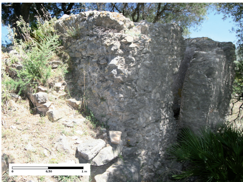
Figura 10. Exterior del depósito hidráulico 1.
